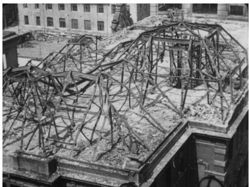
場所：中央／シーン：焼失、倒潰・損壊
